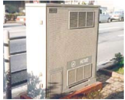
配電ボックス
