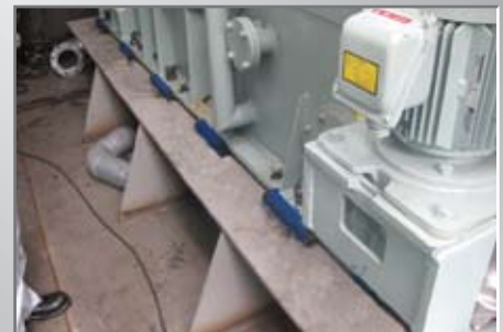
船舶補機エンジン下部、発電機充填用
