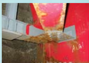
橋桁端部の劣化
