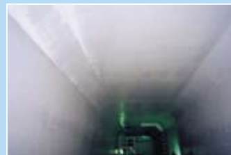
循環器冷却水路(コンクリート)
