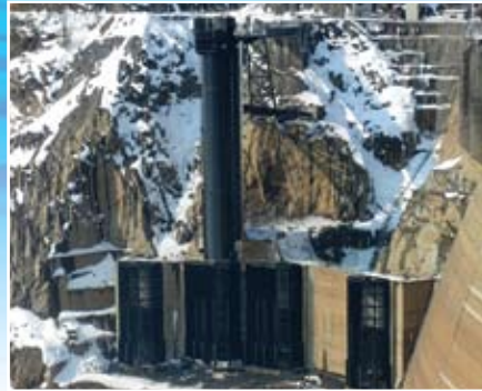
発電所スクリーン
