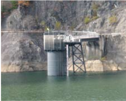
発電所取水ゲート
