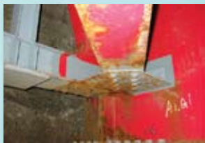
橋桁端部の劣化
